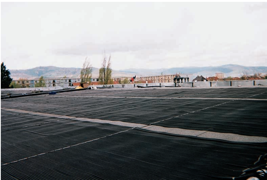
Moquette solaire sur le toit du stade nautique de Colmar
